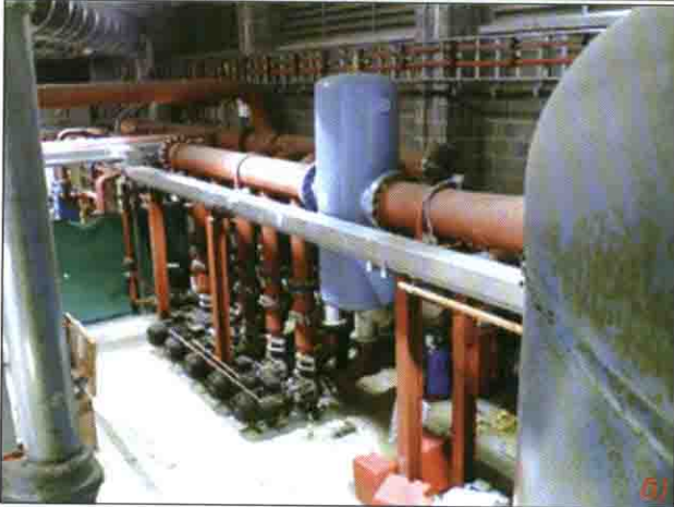
Рис. 12. Примеры установки сепараторов: а – ЦТП Ленинградского вокзала, г. Москва; б – ЦТП университета Абердин, Великобритания.
